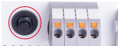
Heizkreissicherung durch Drücken zurücksetzen
