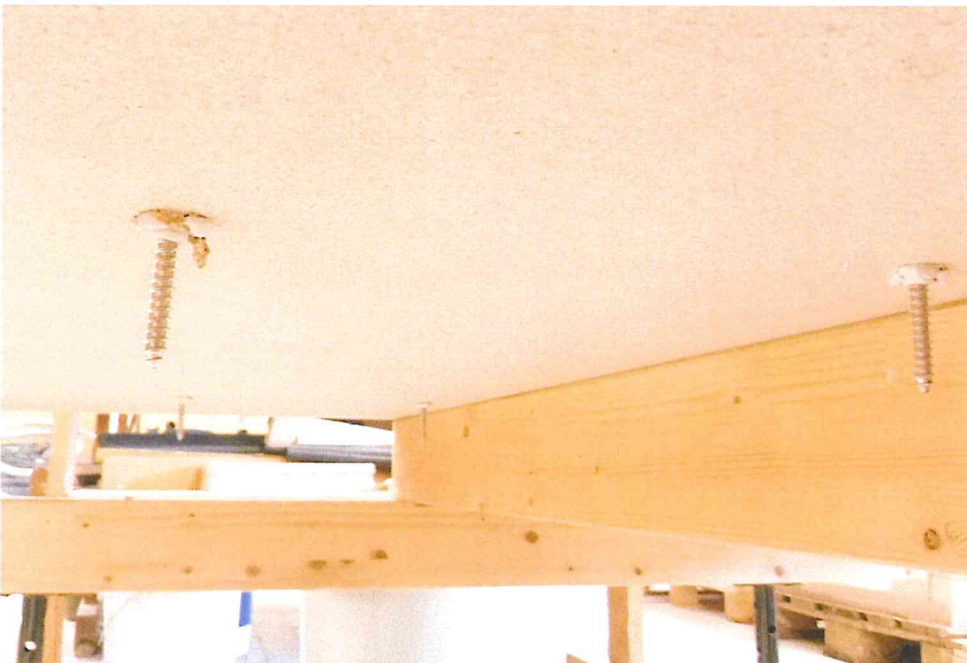
Bild 5: Beckenboden (Unterseite) mit auskragenden Schrauben
